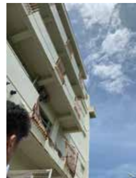
荒浜小学校・津波の傷跡 3階まで到達している。
